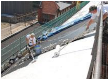
Triflex Maschinenhaus Vattenfall01.jpg
