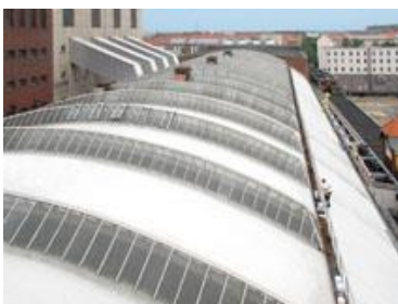
Triflex Maschinenhaus Vattenfall03.jpg
