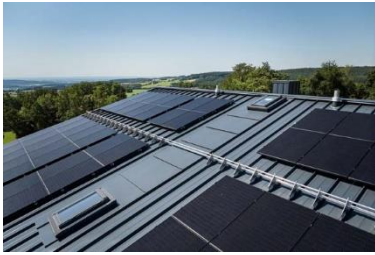
Zambelli_Vorbericht BAU 2025_04.jpg
